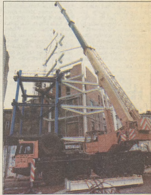
Przy użyciu jednego z najcięższych dźwigów montowano konstrukcję przy remontowanym i rozbudowywanym budynku u zbiegu ulic Retoryka i Zwierzynieckiej. Inwestor, a jednocześnie główny wykonawca Mostostal SA chce w tym miejscu wybudować nowoczesny kompleks hotelowo-usługowy o powierzchni użytkowej 2147 m kw. Na cele biurowe i sklepy przewidziano 350 m2 powierzchni.
