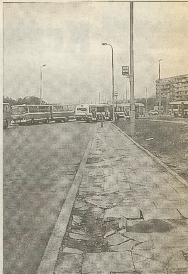
Myliłby się ten, kto by sądził, że na pętli autobusowej w Kurdwanowie wybuchła bomba. Dziury w chodnikach i wyrwane płytki należy przypisać niefrasobliwym kierowcom autobusów. Pętla wprawdzie jest niewielka. Ciężko zmieścić się na niej kilku przegubom. Pasażerowie mają nadzieję, że MPK wyremontuje zdewastowane chodniki. O wypadki tu nietrudno...
