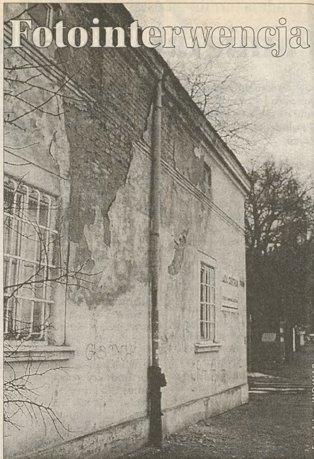
Całymi płatami odpada tynk i fragmenty muru z budynku przy ul. Powiśle w Krakowie, zagrażając bezpieczeństwu przechodniów
