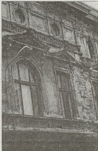
Koszt remontu na pewno będzie ogromne
