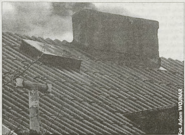
Skorodowany lub uszkodzony eternitowy dach, jest źródłem rakotwórczego pyłu azbestowego
