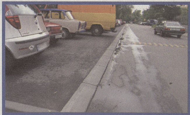
Na terenie osiedla Cegielniana wykonany zostanie remont następnego fragmentu parkingów dla samochodów osobowych przy ul. Borsuczej Fot. Anna Kaczmarz
