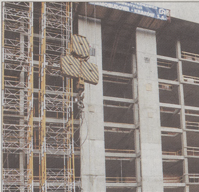
Najbezpieczniej zorganizowane są budowy prowadzone przez duże, wyspecjalizowane firmy Fot. Robert Glac
