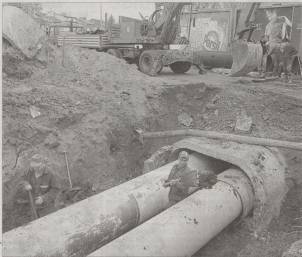
Do awarii magistrali doszło pod jezdnią ulicy Czereśniowej
