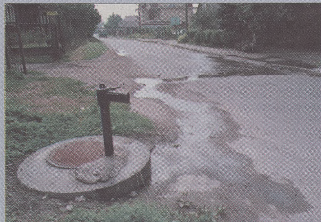
Ul. M. Wańkowicza - ciekące ujęcie wody
