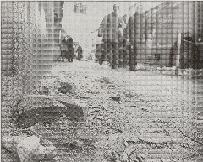
Kawałki muru spadły przed przechodniami
