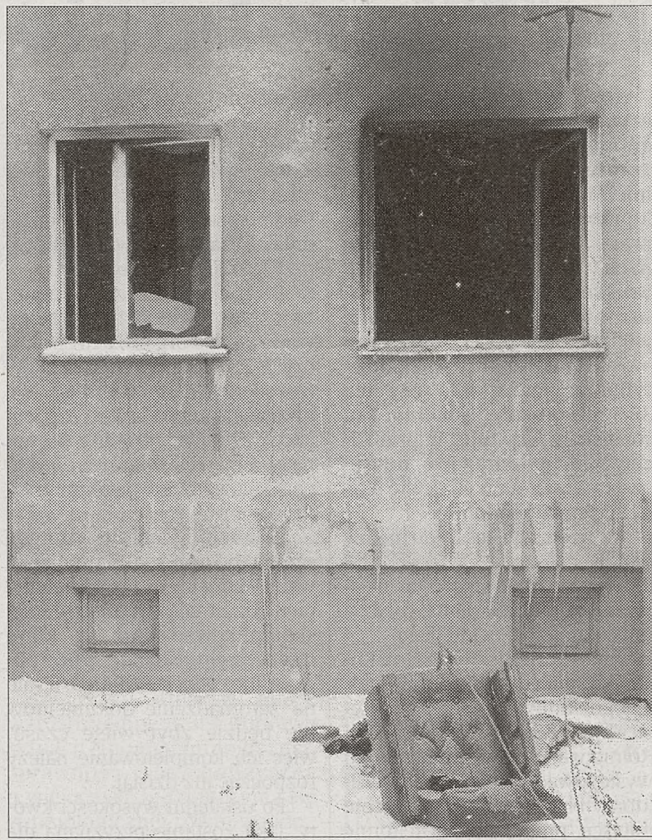
Po pożarze mieszkania przy ul. Słomianej
