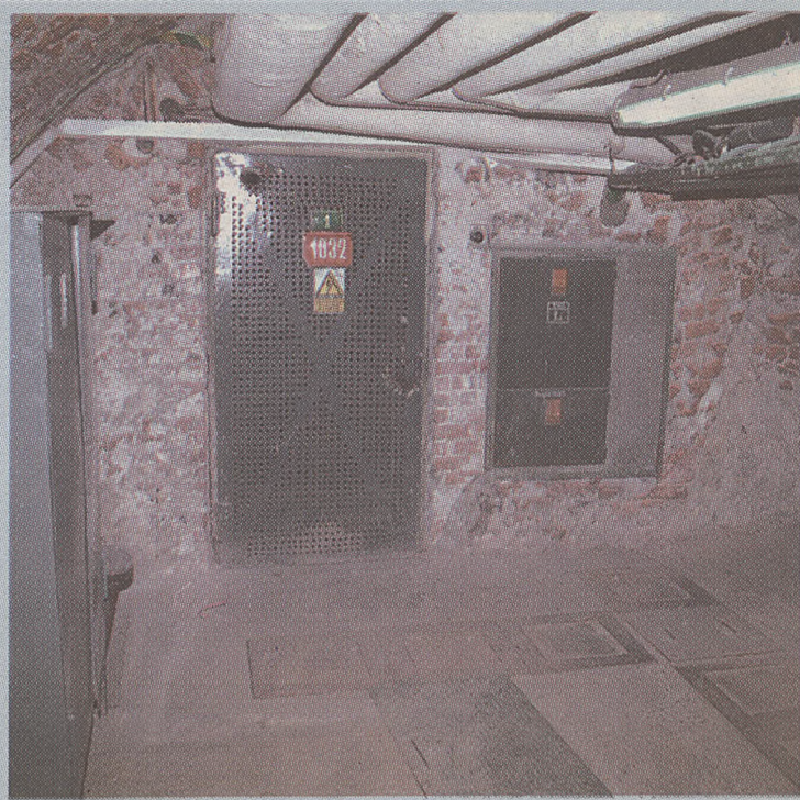
Rozdzielnia prądu w jednej z piwnic
