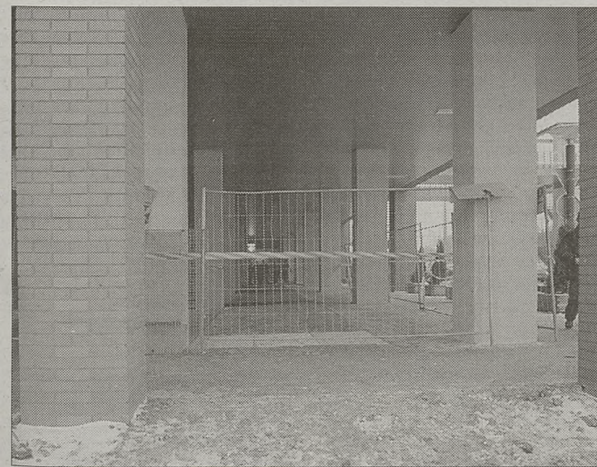
Przejście z kratami na wylotach wentylacyjnych nad podziemnym parkingiem Fot. Anna Kaczmarz
