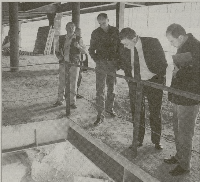
W tunelu szybkiego tramwaju stoi woda
