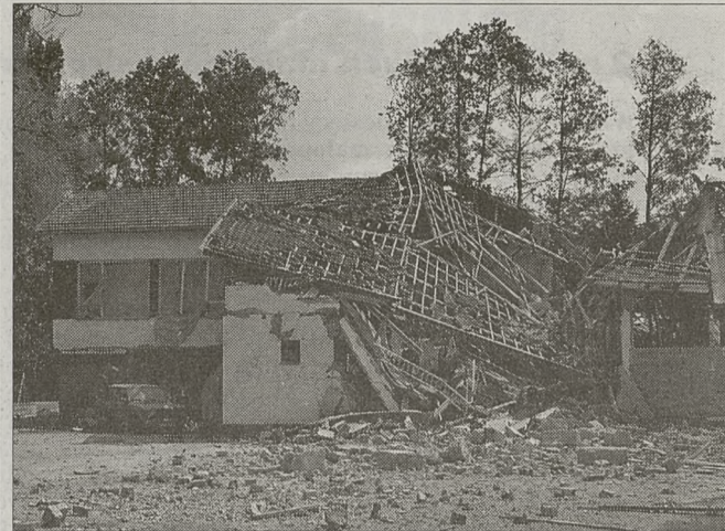
Zniszczony budynek motelu w miejscowości Celopek koło Tetova Fot. PAP/EPA
