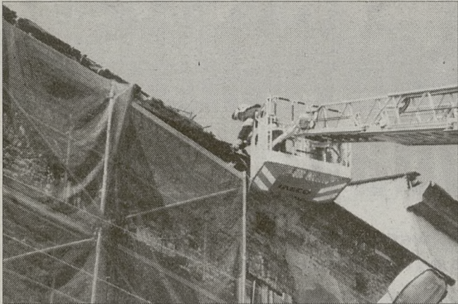
Straż pożarna już po raz trzeci zabezpiecza zrujnowaną kamienicę
