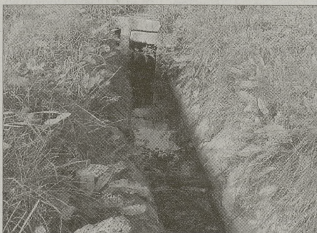
Biskupice. Ścianki kanału ściekowego biegnące z „Sarii” w gminie Gołcza pokrywa gruba warstwa wyschniętej, tłustawej substancji.
