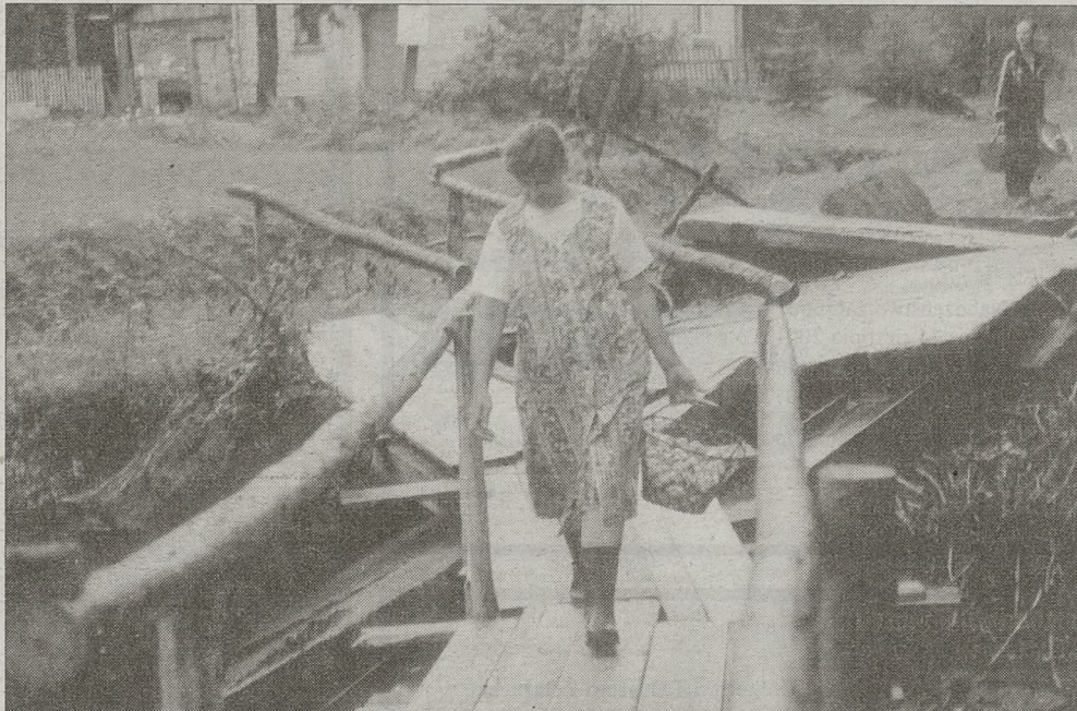
Żeby przynieść chociaż część plonów z pola, Zofia Kucaj musi kilka razy dziennie przechodzić przez kładkę nad zniszczonym mostem
