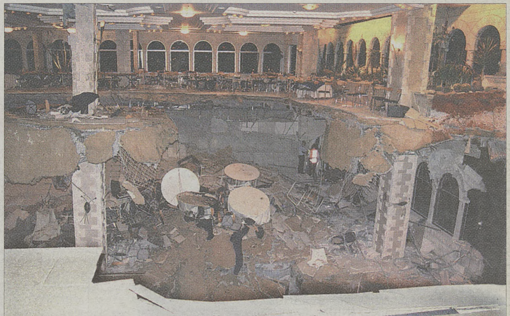
Zawalony budynek domu weselnego w Jerozolimie
