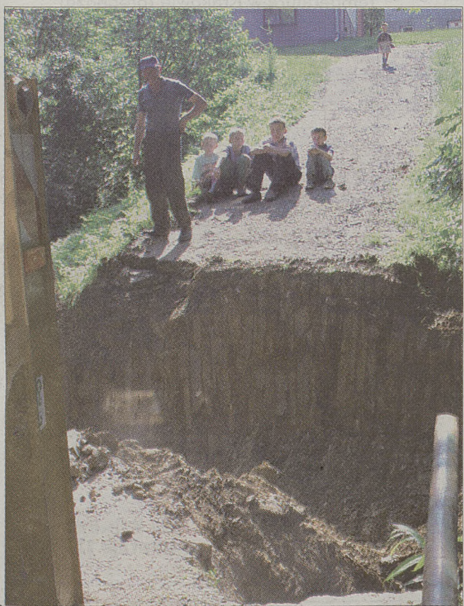
Woda zniszczyła przyczółki mostu
