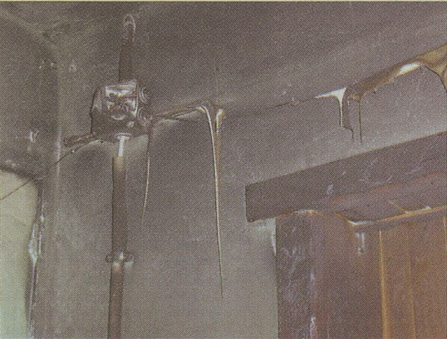
W skutek wysokiej temperatury stopiły się instalacje znajdujące się na klatce schodowej Fot. ALG
