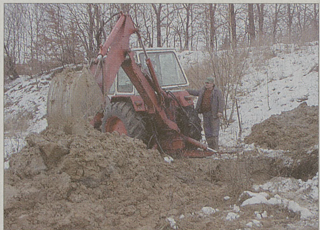
Bez użycia koparki nie było mowy o dokopaniu się do pękniętej rury zaopatrującej w wodę os. Sikorskiego
