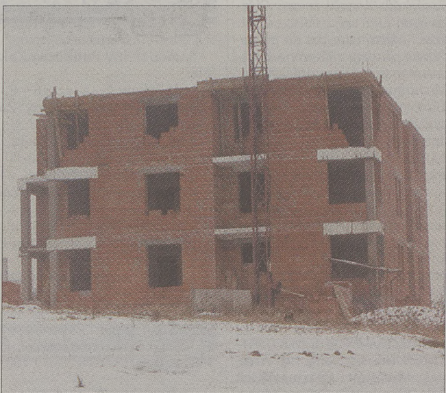
Blok TBS-u przy ulicy Leśnej od października czeka na ekipę budowlaną
