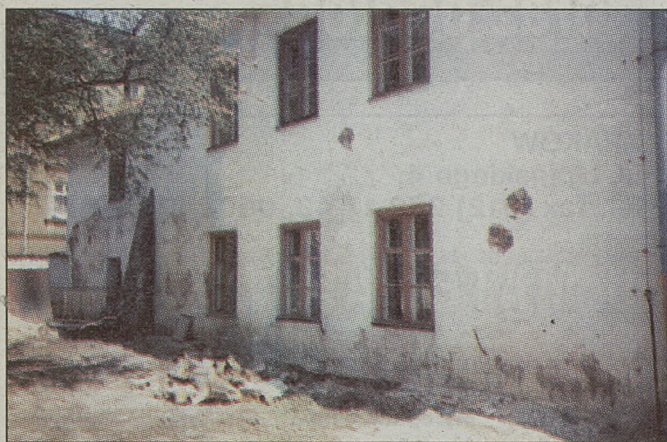
Budynek był bardzo zniszczony i zawilgocony
