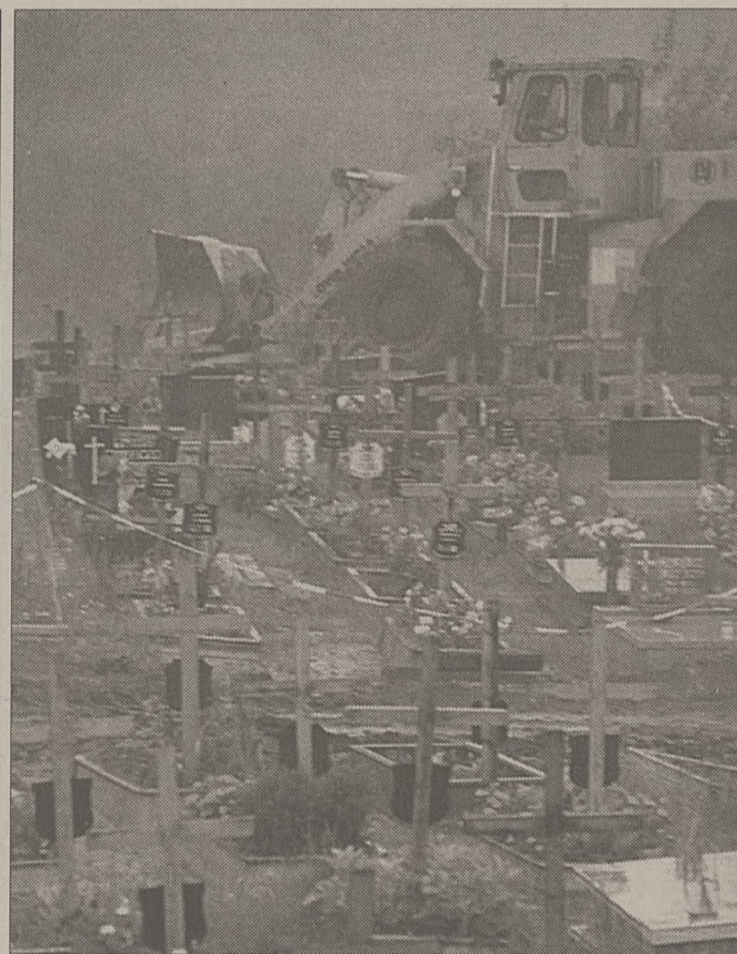
Na cmentarzu komunalnym w Rybniku, mimo ulewnych opadów deszczu, nadal trwają prace przy usuwaniu skutków obsunięcia się skarpy, na której znajdowało się kilkadziesiąt grobów. Doczesne szczątki zmarłych zostaną pochowane ponownie w zbiorowej mogile.
