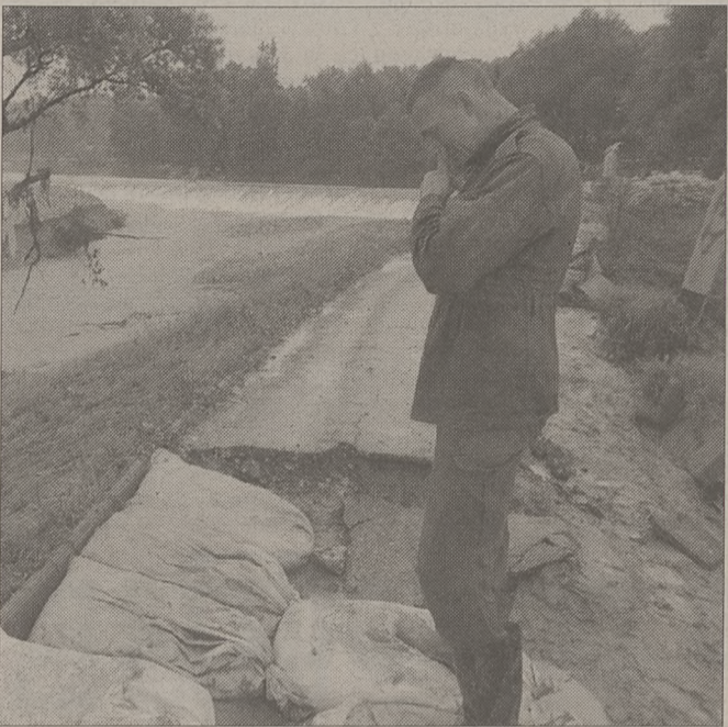
Przerwany wał przeciwpowodziowy w Kłodzku.
