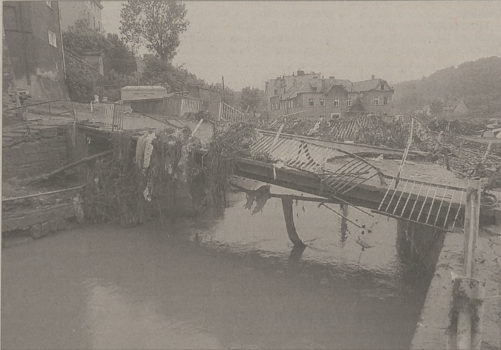
Tak wygląda jeden ze zniszczonych mostów na Nysie Kłodzkiej
