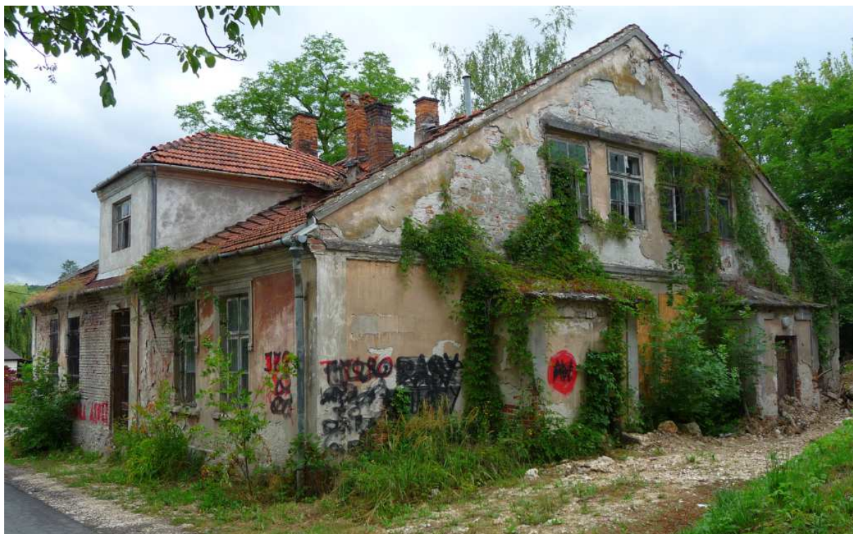
Fot. nr 427 (427-433). Wybudowany ok. roku 1930 budynek (podworski?) pod nr 23, gdzie mieścił się Wiejski Ośrodek Zdrowia, wpisany do GEZ dla Gminy Liszki, dziś romantyczna ruina. (10.07.2025)
