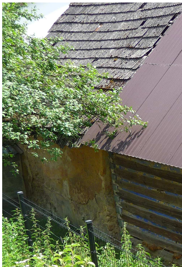
Fot. nr 397. Murowany fragment jeszcze z dachówką, w dawnej części gospodarczej.
