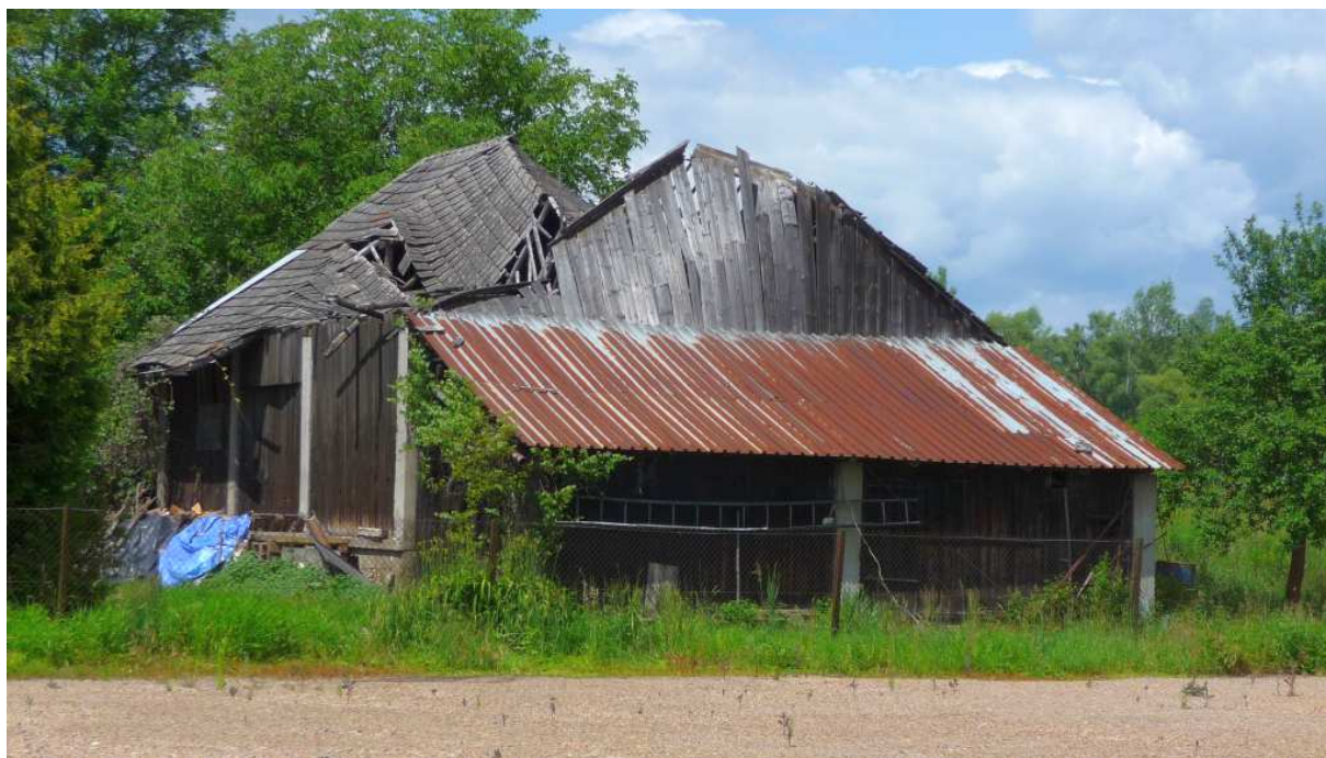
Fot. nr 401. Zawalony dach rozległej stodoły. (24.06.2025)
