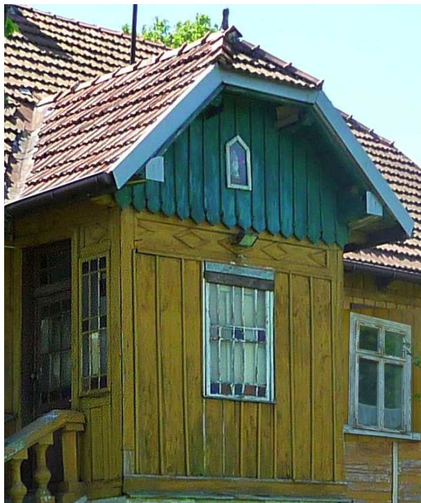
Fot. nr 472. Mocno podniszczony dziś ganek z mozaikowymi kiedyś oknami. (10.05.2026)
