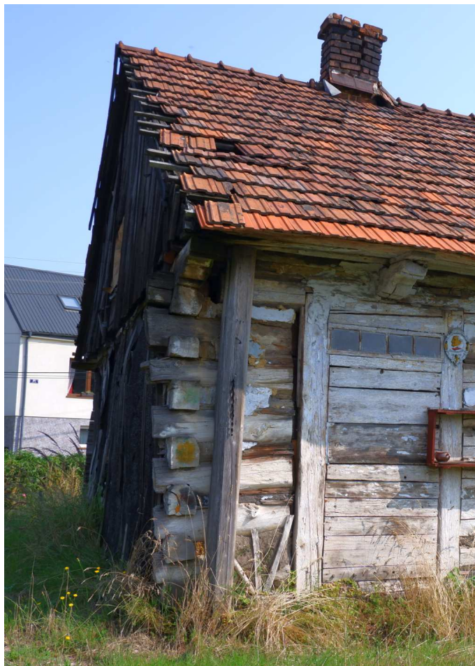
Fot. nr 180. Boczna ściana, jakby sztucznie zaślepiona i zamurowane oryginalne drzwi ze świetlikiem w przelotowej sieni. Przykład konstrukcji zrębowej. (14.07.2023)
