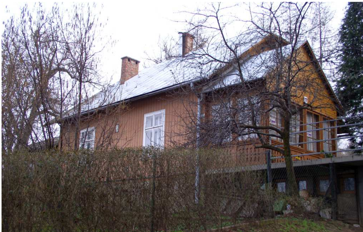
Fot. nr 466 (466-469). Plebania przy kościele św. Sebastiana pod nr 23 przed i po remoncie (fot. nr: 467-469), kiedy jej fasada uległa znacznym zniekształceniom. (05.04.2009)
