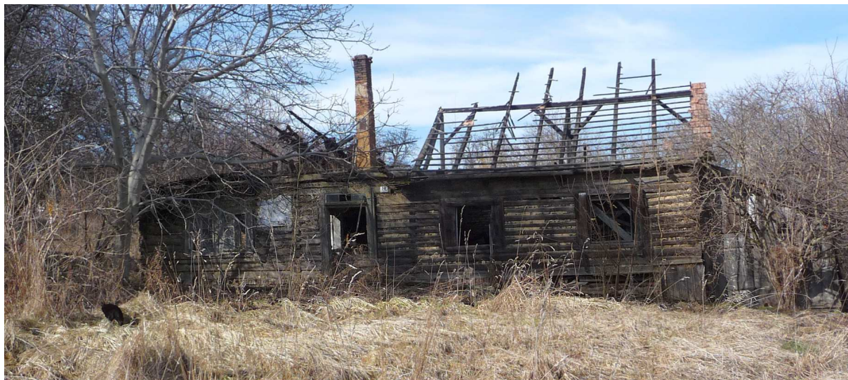
Fot. nr 459 (459-460). Próba uchwycenia nieodwracalnej ruiny rozległej chałupy spod nr 10, która najwyraźniej spłonęła. (15.03.2012)
