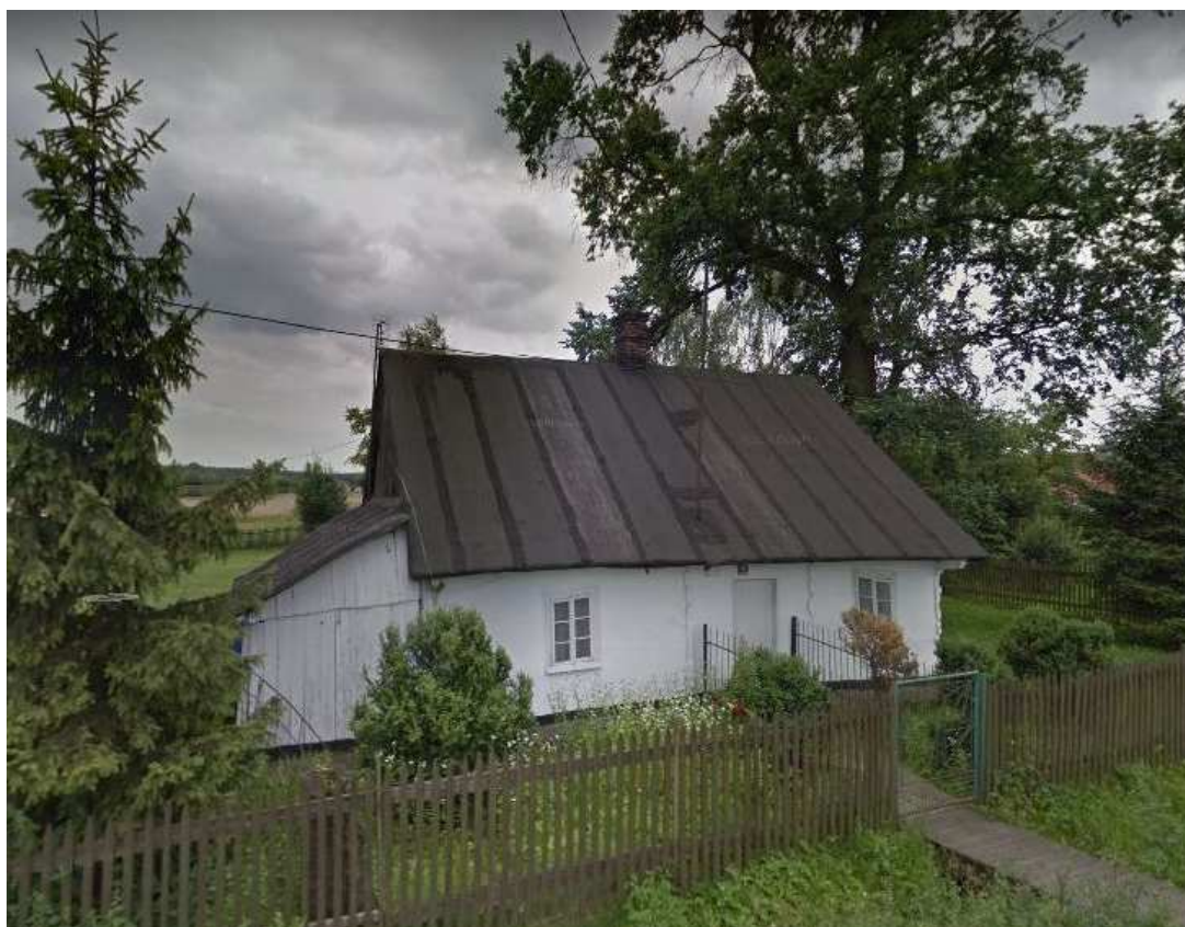
Fot. nr 6a. Chałupa z ulicy Batorego 62. W roku 2010 była pęknięta w połowie i lekko przesunięta wzdłuż tej osi.
