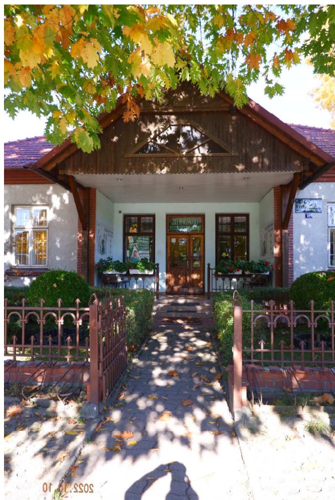
Fot. nr 174. Okap nad wejściem.
