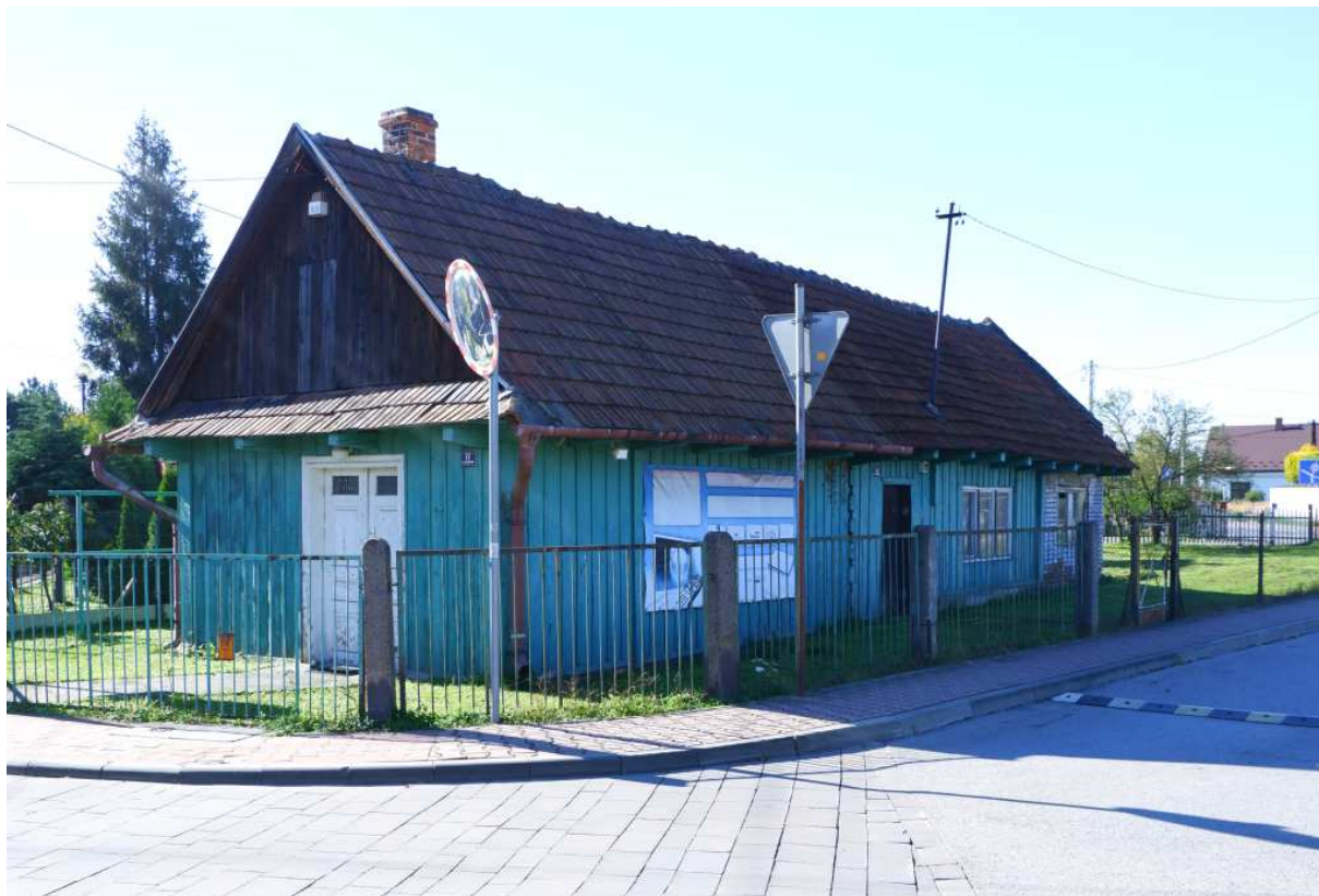
Fot. nr 221 (221-224). Oszalowany dom z nieoryginalnymi oknami, zapewne dawna chałupa, spod nr: 11-13.
