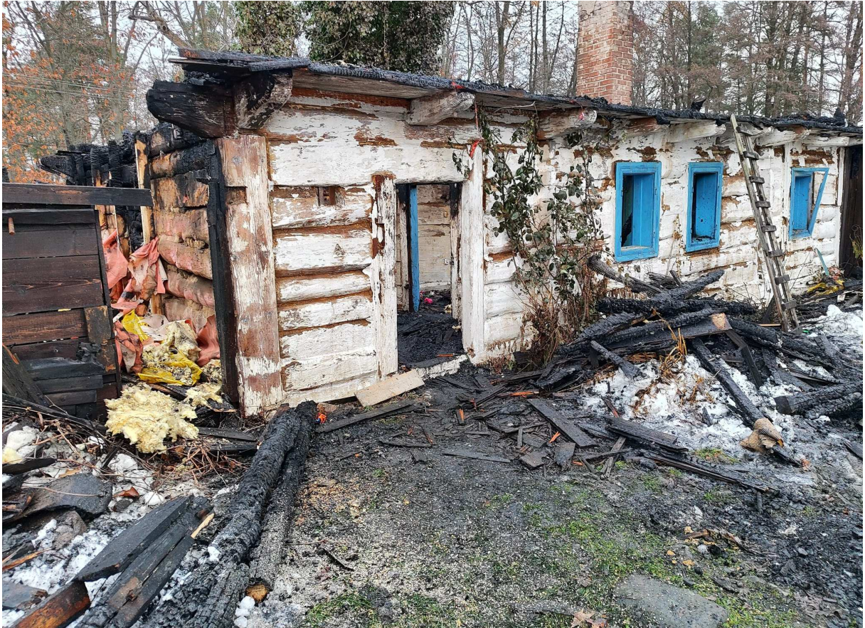
Fot. nr 6c. Ruina po pożarze. (11.12.2023)
