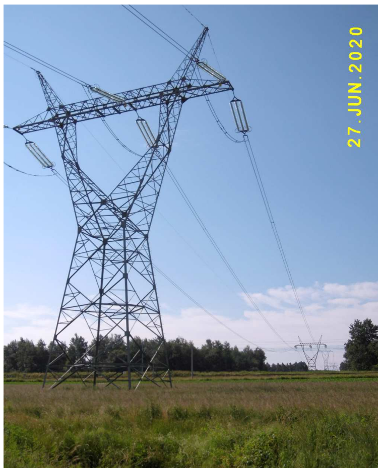
Fot. nr 455. Pomrująca linia wysokiego napięcia.
