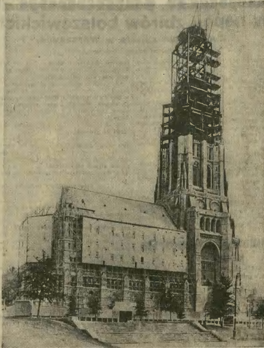
Wobec tego, że drewniany kościół nad Hudson River, w Nowym Jorku ufundowany przez znanego milionera amerykańskiego Rockefellera, spłonął na wiosnę doszczętnie, zbudowano obecnie kościół cały ze stali, który przedstawia nasza ilustracja.
