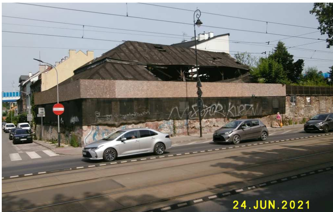
Fot. nr 429. Już chyba nic nie uratuje klasycystycznego dworku złamanym dachem z końca XVIII wieku z ulicy Limanowskiego 47, zdegradowanego po pożarze.
