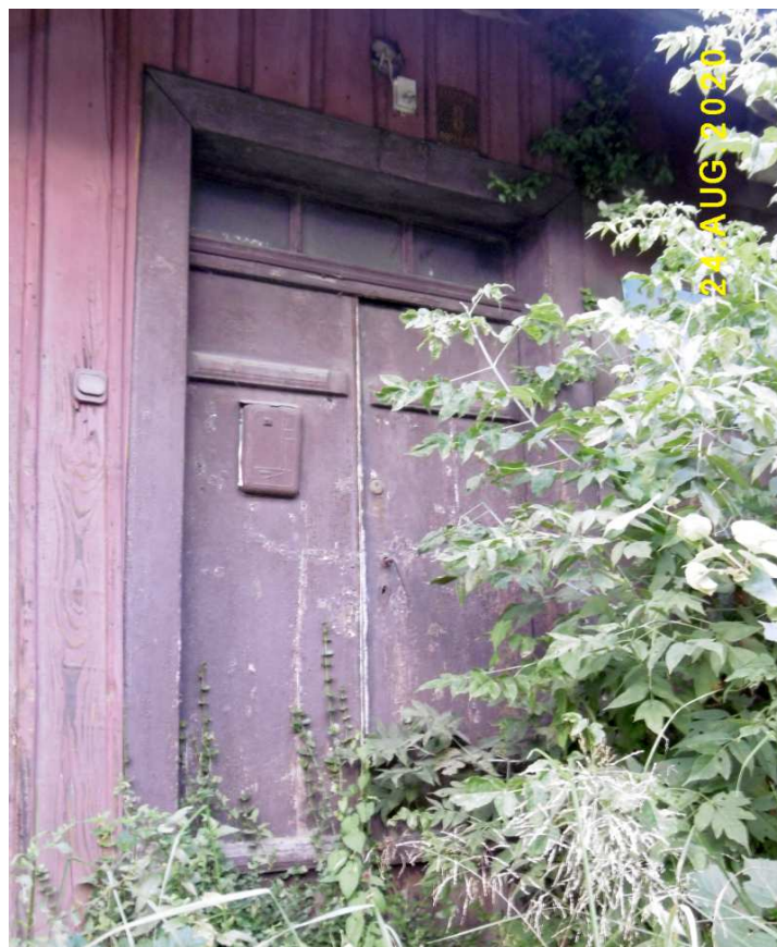
Fot. nr 47a. Zarośnięte drzwi wejściowe. Widać, że jest niezamieszkała od dawna.
