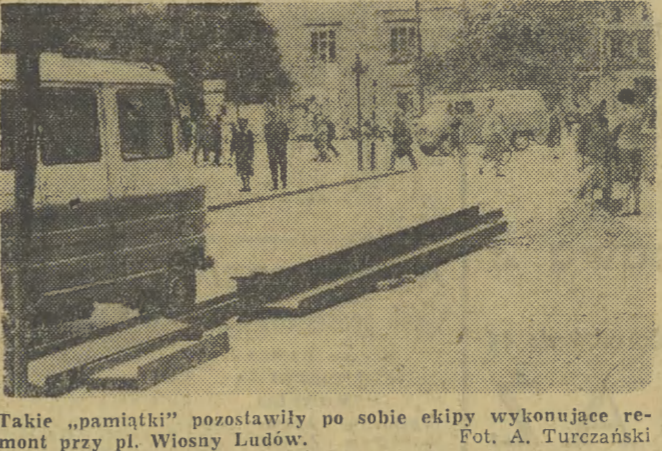
Takie „pamiątki” pozostawiły po sobie ekipy wykonujące remont przy pl. Wiosny Ludów.
