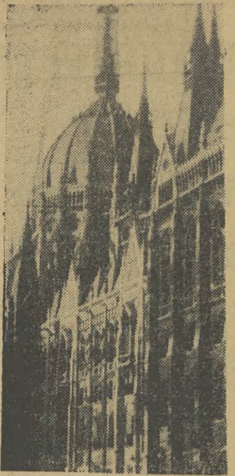
BUDAPESZT Ogromny gmach Parlamentu znajduje się w remoncie generalnym. Nowe są wszystkie, widoczne na zdjęciu, jasne elementy kamieniarskiej elewacji. Odnowia się również iglicę kopuły, którą otacza rusztowanie. Fot. St. Zawadzki
