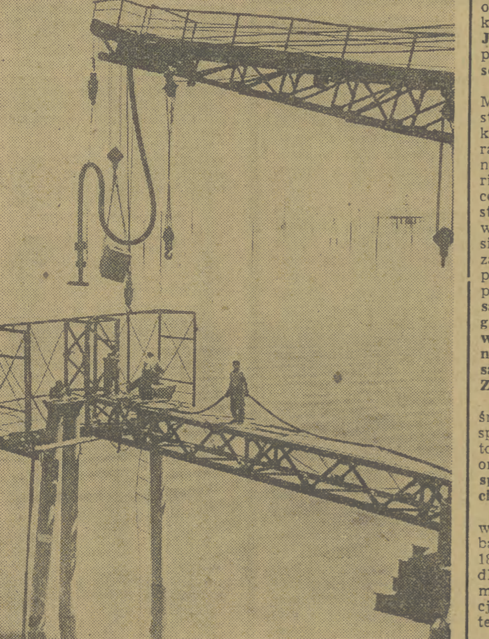
W rejonie wyspy Płaszczystej na Morzu Kaspijskim w ZSRR buduje się żelazobetonowy pomost dla wydobycia ropy naftowej spod dna morskiego. Pomost ten będzie miał ponad pół kilometra długości i wznosić się ma 10 m nad poziomem wody. CAF — fot.
