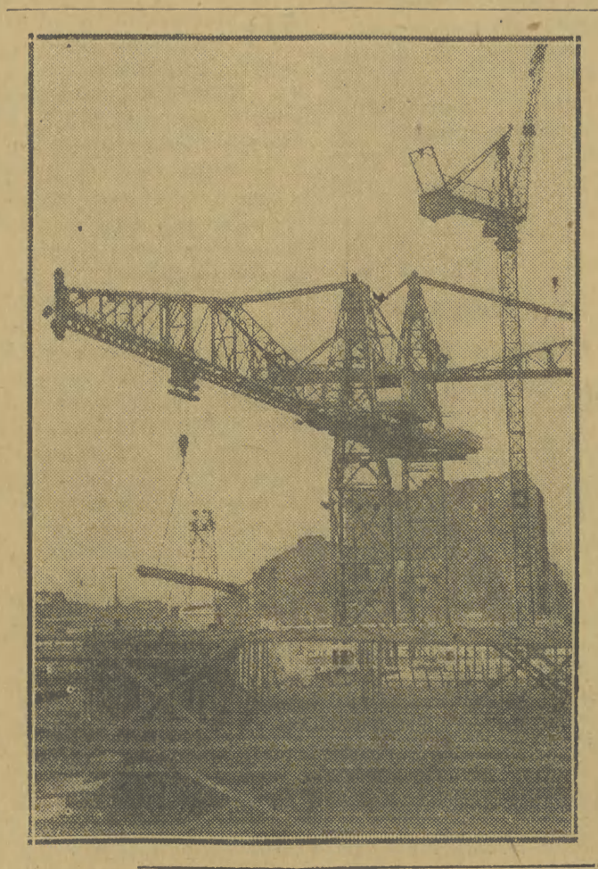
Prace przy budowie Pałacu Kultury i Nauki połączają w szczytnym tempie naprzód. Na zdjęciu: zbrojenie szkieletu ściany fundamentu CAF — D.K.W. Marjnow
