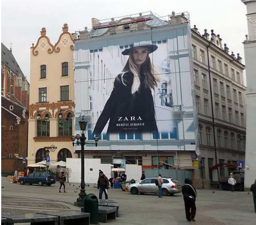
Fot. nr 91. Kamienica Biedermanowska pod nr 5 jako baner reklamowy podczas jej remontu. (16.01.2014)
