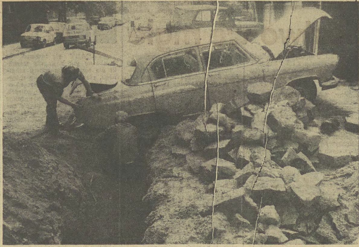
Trwa wymiana rur kanalizacyjnych w os. Kolorowym. Cieszą się z tego mieszkańcy, ale chyba nie wszyscy... Kierowca tej „wołgi” wpadł do kanału próbując przejechać po położonej desce. Fot. J. BEDNARCZYK
