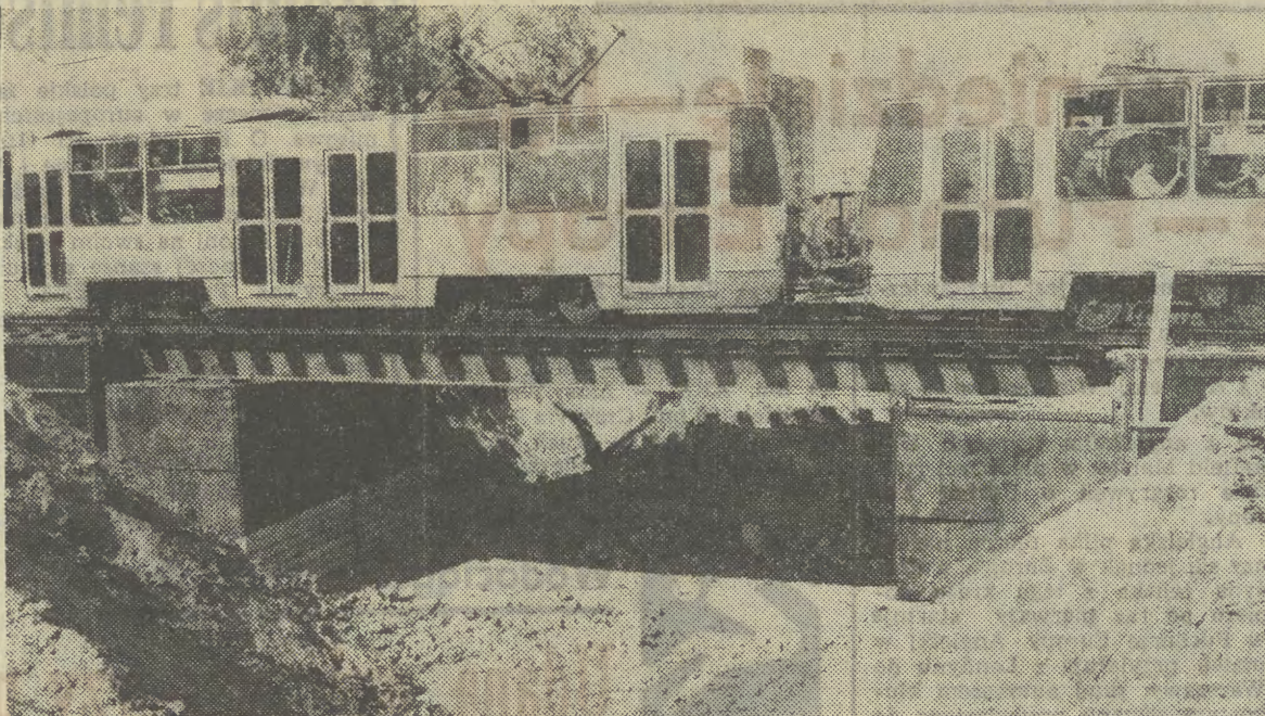
Do piętnastego listopada tramwaje jeżdżące ul. Planu 6-letniego przejeżdżać będą po torowisku podwieszonym nad kilkumetrowej szerokości wykopem...
