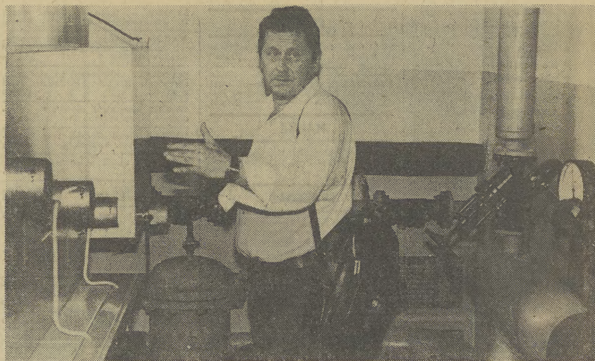
Nowoczesną kotłownię gazową składającą się z 4 członów firmy „Hydrotherm” z RFN, dostarczającą ciepłą wodę i ogrzewającą zrewaloryzowany budynek przy ul. Solińskiego, prezentuje inż. Józef Galos, specjalista w tej dziedzinie, zatrudniony w Zarządzie Rewaloryzacji Zespołów Zabytkowych Krakowa. Fot. JACEK BEDNARCZYK
