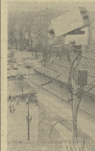
Tak wygląda kamera ustawiona na dachu budynku przy ul. Powisie.
