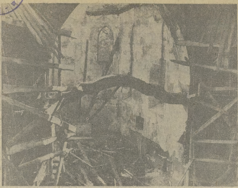
Zupełnie zniszczone przez pożar prezbiterium kościoła w Niedźwiedziu.
