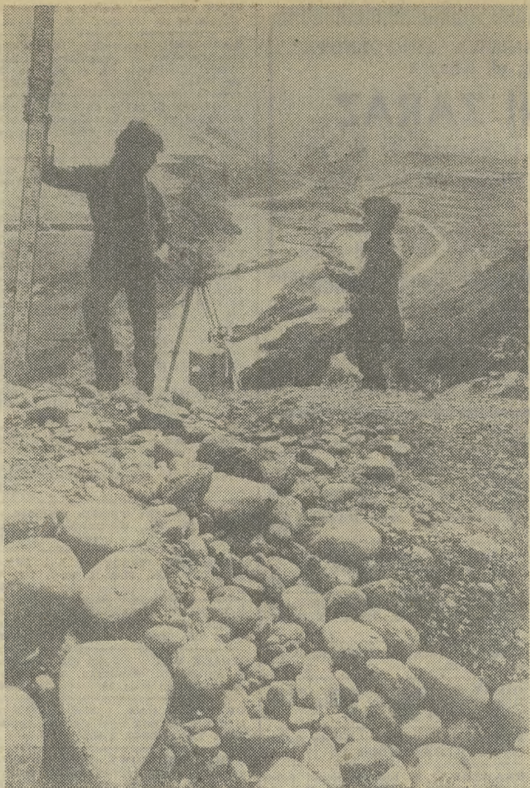
W Tadżyckiej SRR, na rzece Wachs, powstają kolejne elektrownie. Na zdjęciu: prowadzenie pomiarów w miejscu, gdzie stanie tama Elektrowni Roguńskiej o mocy 3600 MW.
