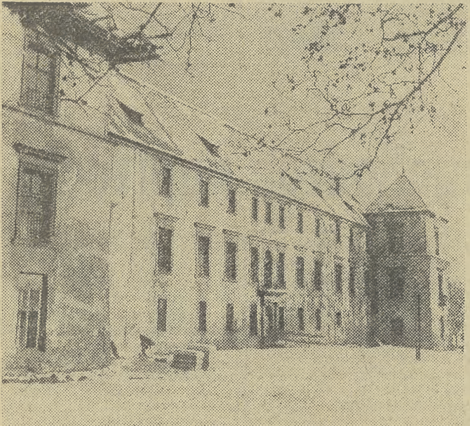
Zamek w Suchej od strony parku czeka na remont i konserwację.
