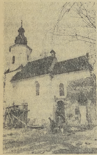
Odnoviony zabytkowy kościół św. Salvatora od strony południowej. Na rusztowaniach estakada odnowa — ściennego epita-fium.
