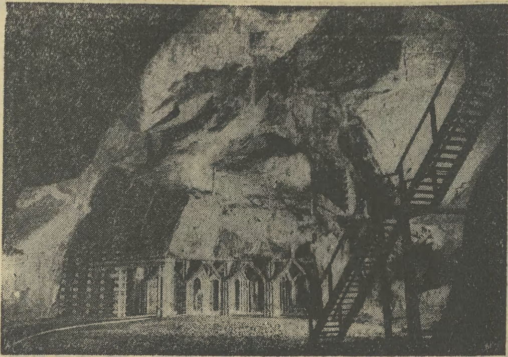
Komora „Maria-Teresa” — w głębi u dołu widoczna obudowa drewniana, ściany boczne oraz strop zostaną zabezpieczone metodą kotwiciową. Znajduje się na poziomie III kopalni, 135 m pod ziemią. Komora ta od lat wyłączona jest dla zwiedzających z powodu zagrożenia.
