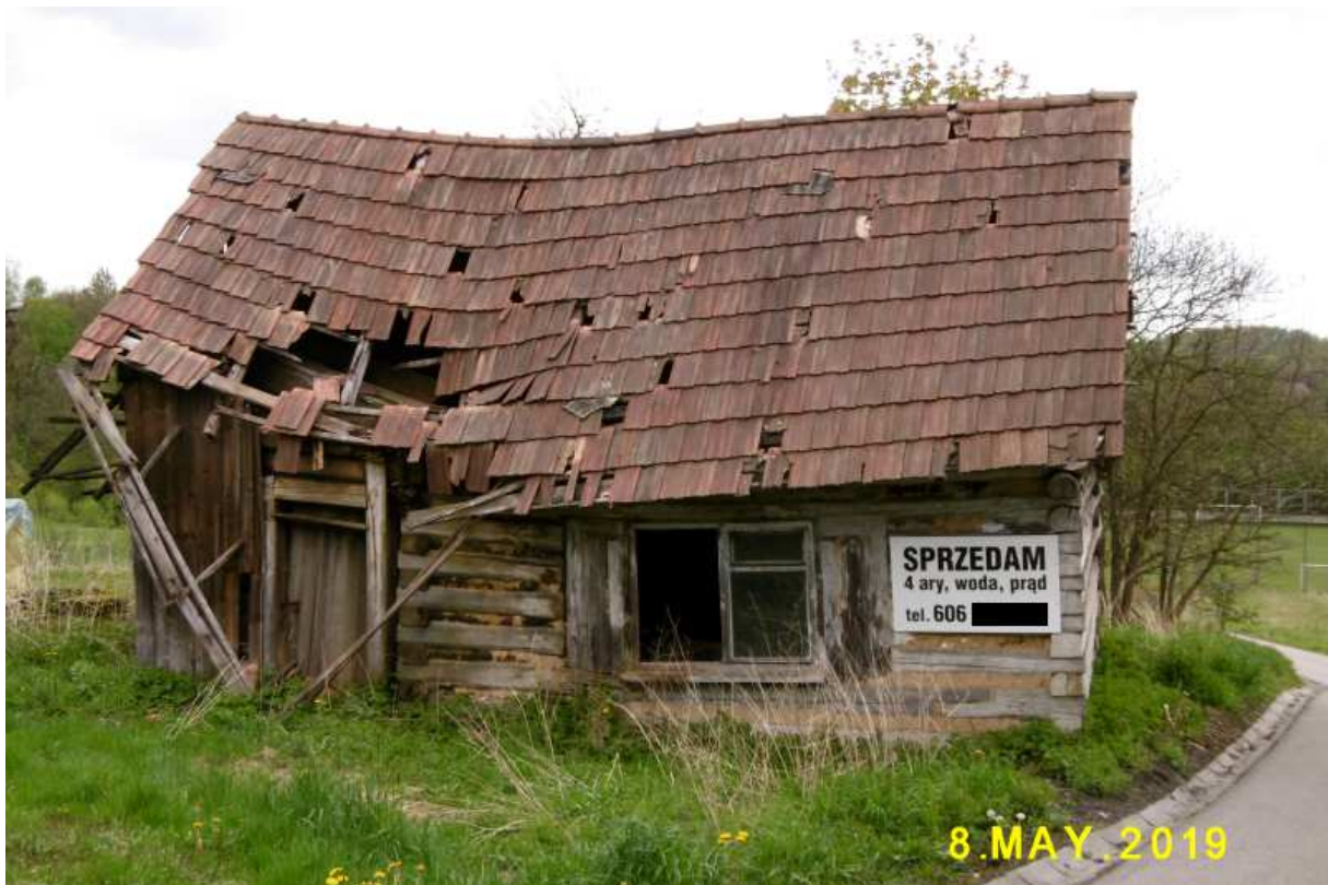
Fot. nr 393 (393-395). Ruina zapewne XIX-wiecznej chałupy spod nr 50 (?) przy ulicy Wadowickiej, zlokalizowanej poniżej domu o nr 201.
