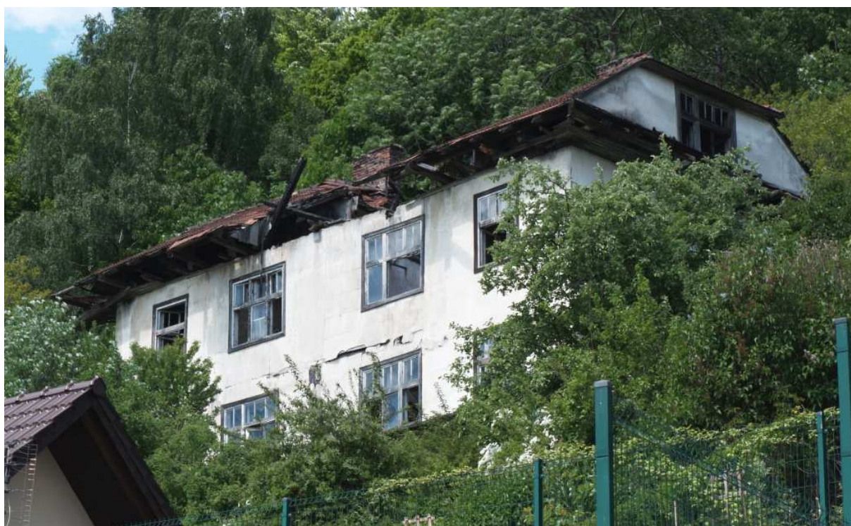
Fot. nr 303. Zrujnowana dziś willa Widok spod nr 25, która zapewne została wybudowana w latach 30. zeszłego wieku. Miała bogate wyposażenie wewnątrz, z czego do dziś zapewne nic nie zostało, bo nie figuruje nawet w GEZ. Jak nieistniejąca już willa Róż w czasach okupacji niemieckiej była ulubionym miejscem pobytu hitlerowskich dygnitarzy.
