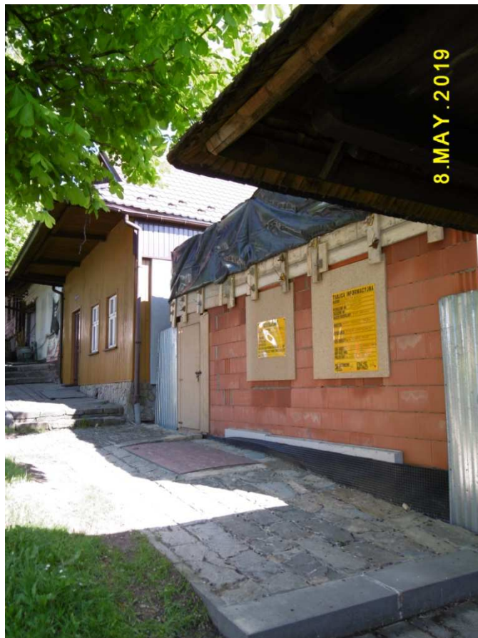
Fot. nr 29. Fragment zabudowy do nr 7. Drewno zastępuje cegła.
