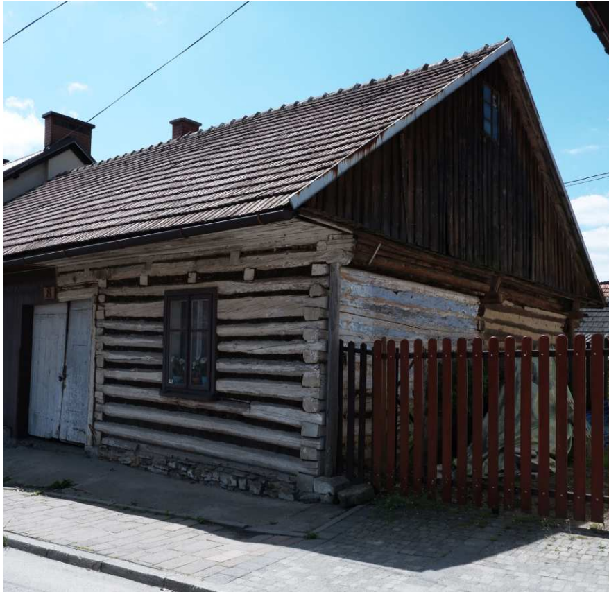
Fot. nr 340. Oryginalny, prawy fragment fasady o konstrukcji zrębowej. Część bocznej ściany posiada jeszcze pozostałe z oryginału bielienie.
