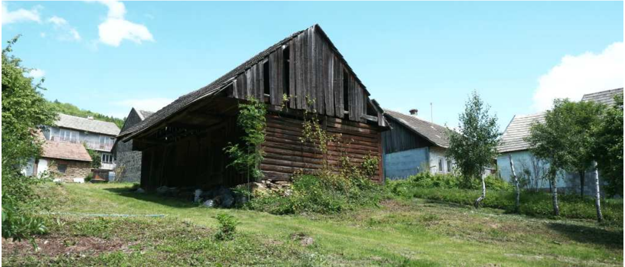
Fot. nr 356 (356-357). Stodoła w bliskości domu pod nr 8 – dawniej nr 201 (pośrodku), datowana na I połowę XX wieku. Sam dom o konstrukcji zrębowej (na prawo od stodoły), lecz nieco zmodyfikowanej już, choć nadal bielonej fasadzie, jest datowany na II połowę XIX wieku. W tle zabudowa ulicy Jagiellońskiej.
