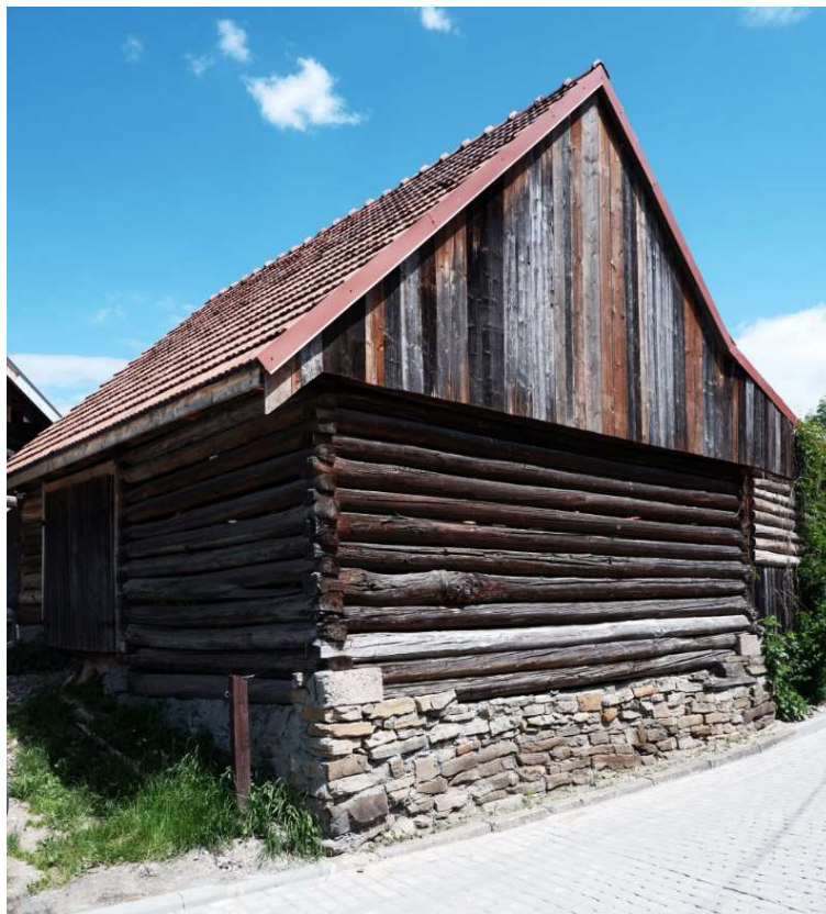
Fot. nr 351 (351-351a). Stodoła naprzeciw domu o nr 7, wybudowana zapewne w I ćwierci XX wieku. Stan z 02.06.2021.
