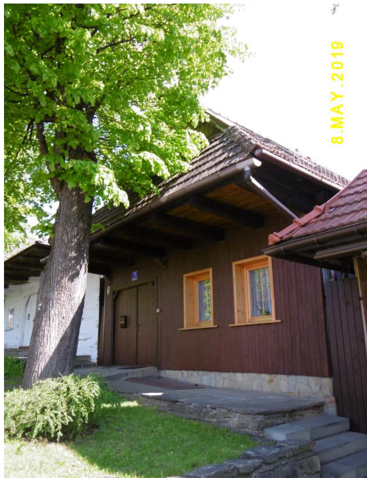
Fot. nr 36. Dom spod nr 15 (dawniej 140), wybudowany w roku 1901. Przykład, jak plastikowe, bez dawnych podziałów okna mogą zeszpecić fasadę.
